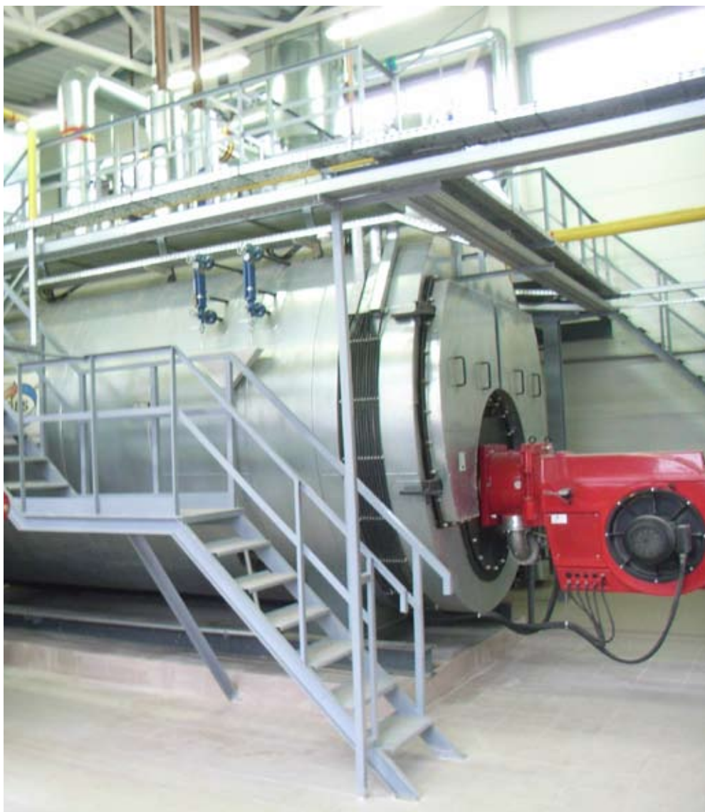
Ny dampkedel hos ScanDye, som med en høj virkningsgrad sikrer optimal energiudnyttelse.
